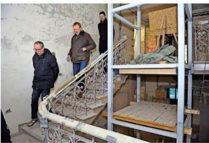
Im Treppenhaus ist das originale Geländer wieder aufgearbeitet worden. In der Mitte wird ein Fahrstuhl eingebaut. Quelle: Enrico Kugler
