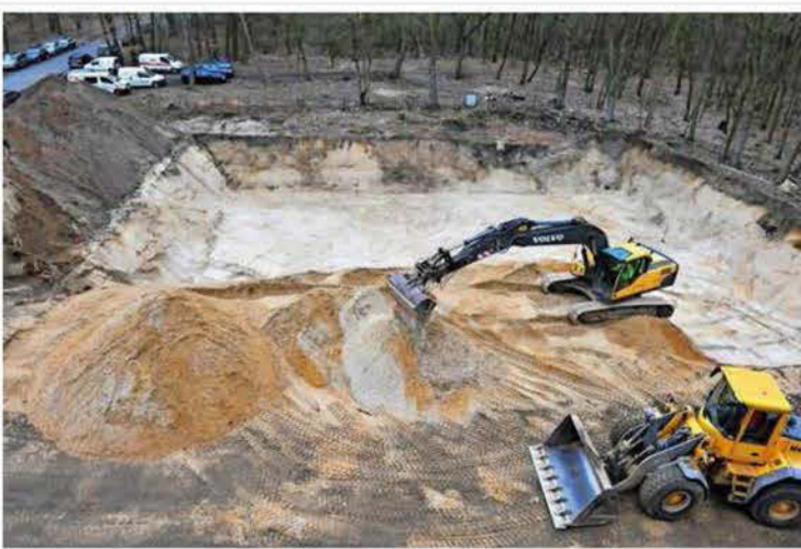
Der nächste Bauabschnitt ist bereits in Gange. Links von der Villa sind die Baugruben für zwei Stadtvillen ausgehoben. In dem großen Baufeld rechts von der Villa werden noch einmal sechs Häuser und eine Tiefgarage entstehen. Quelle: Enrico Kugler
